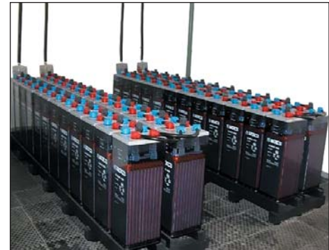
Рис. 11. Фрагмент подстанционной батареи на номинальное напряжение 230 В, состоящей из 106 последовательно соединенных свинцово-кислотных аккумуляторов с положительными электродами Планте
