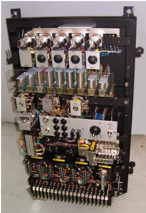
Рис. 3. Шедевр релестроения – электромеханическое реле трехступенчатой дистанционной защиты типа LZ31, выпускавшееся фирмой ASEA в 70-х годах и до сих пор надежно защищающих линии высокого напряжения 110 – 220 кВ во многих странах мира (со снятой крышкой-дверцей).
