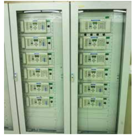
Рис. 7. Релейные шкафы со стеклянными дверями
