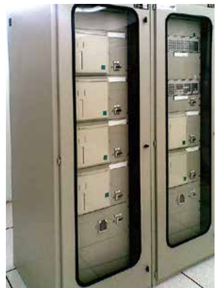
Рис. 2. Микропроцессорные устройства релейной защиты, смонтированные в шкафах со стеклянными дверями
