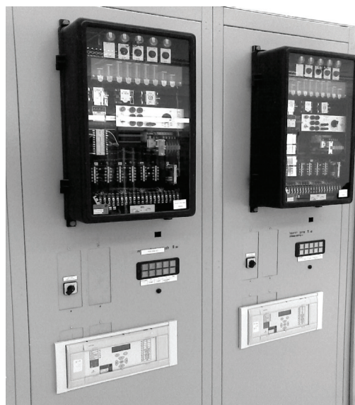
Рис. 1. Фрагмент панели дистанционной релейной защиты линии 160 кВ с МУРЗ типа MiCOM P437 (внизу), дублированного электромеханическим реле LZ-31 (вверху), включенными на параллельную работу
