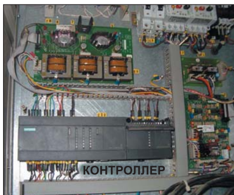
Рис. 9. Контроллер типа SIMATIC S7-200 (Siemens), используемый в ЗПА компании ELCO для управления процессом разряда батареи на питающую сеть.
