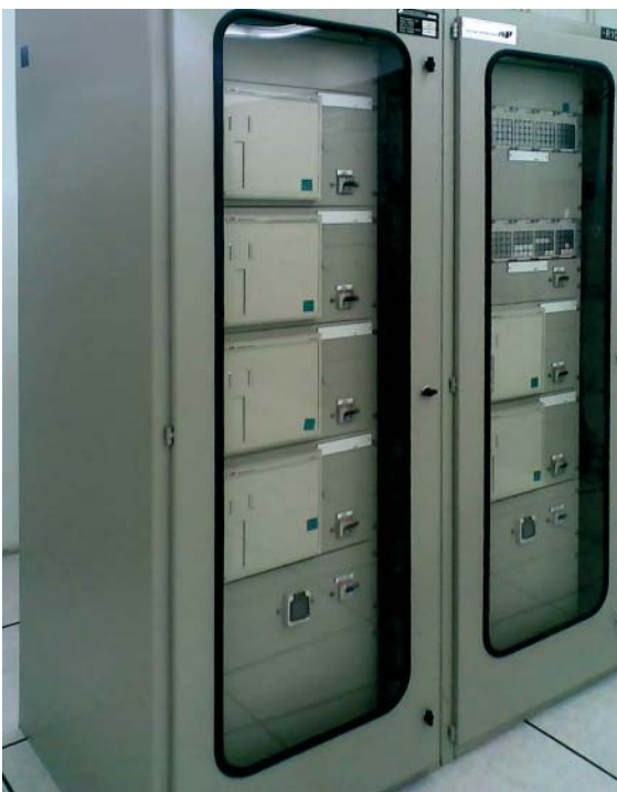
Рис. 4. Современный способ монтажа МУРЗ в релейных шкафах
