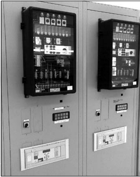
Рис. 2. Дистанционная защита линий, выполненная на МУРЗ типа MiCOM P437 (внизу) и электромеханических реле типа LZ-31 (вверху), включенных на параллельную работу
