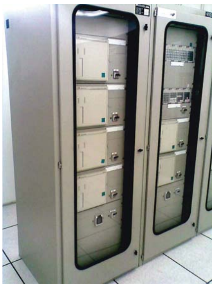
Рис. 57. Шкафы с установленными в них МУРЗ
