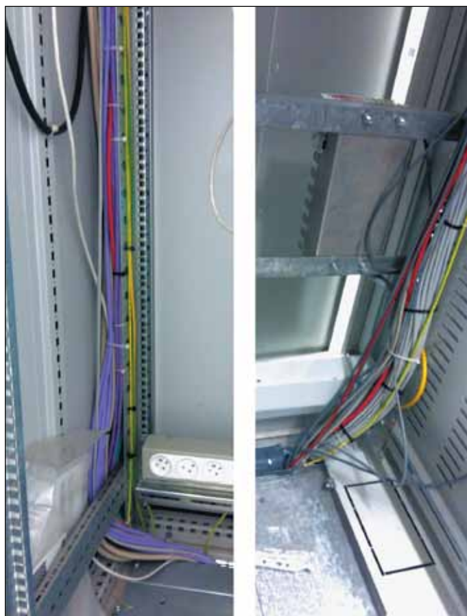
Рис. 6. Кабельные жгуты, заведенные в монтажные шкафы системы телекоммуникации через открытое пространство в полу
