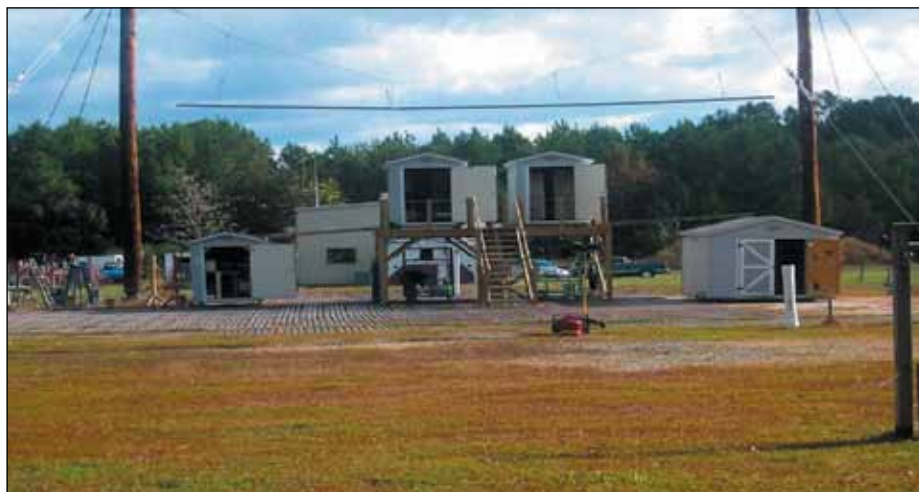
Рис. 6. Испытание системы SCADA на устойчивость к ЭМИ ЯВ (вверху видна антенная система симулятора ЭМИ, элементы системы SCADA расположены в отдельных боксах и соединены между собой стандартной системой связи)
