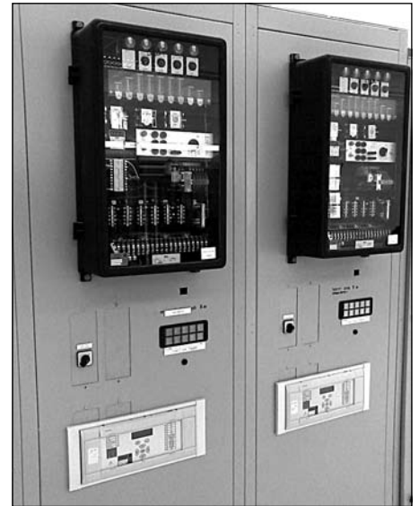
Рис. 24. Дистанционная защита линий, выполненная на МУРЗ типа MiCOM P437 (внизу) и электромеханических реле типа LZ-31 (вверху), включенных на параллельную работу
