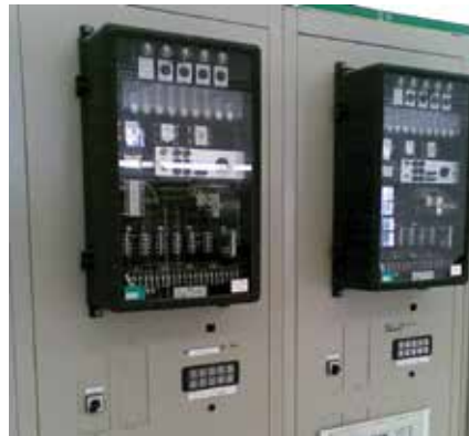
Рис. 4. Фрагмент панели дистанционной защиты ответственных линий 160 кВ, содержащей электромеханические реле типа LZ31 (вверху), включенные на параллельную работу с микропроцессорными защитами типа MiCOM P437 (внизу)
