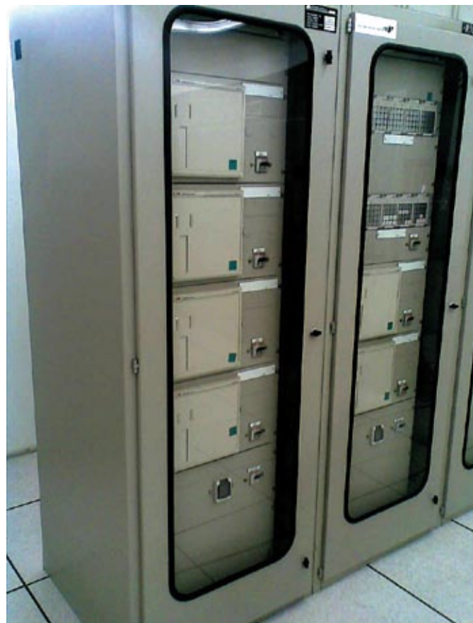
Рис. 2. Современный способ монтажа МУРЗ в релейных шкафах
