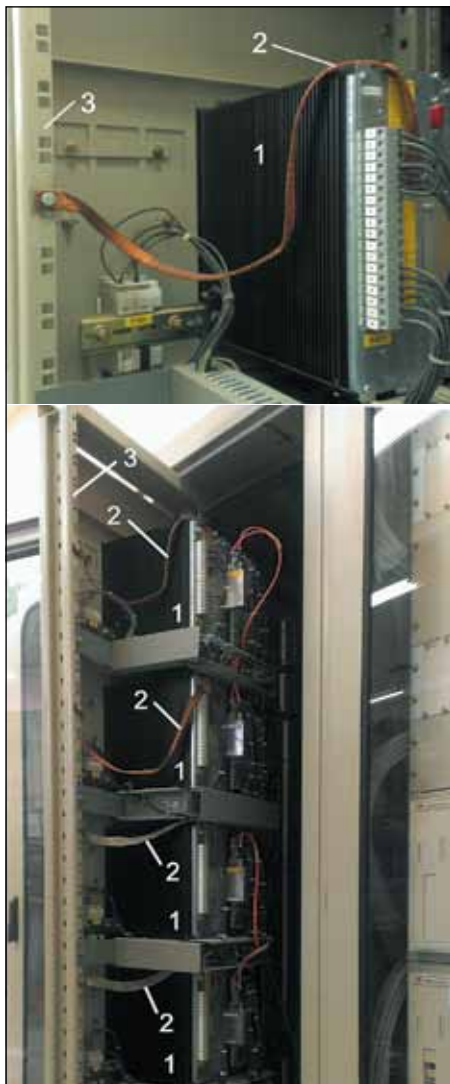
Рис. 2. Устройство заземления МУРЗ, установленных в металлических шкафах, с использованием эквипотенциальной поверхности: 1 — МУРЗ в металлических корпусах; 2 — заземляющие медные шинки; 3 — элемент конструкции металлического шкафа, исполняющего роль эквипотенциальной поверхности
