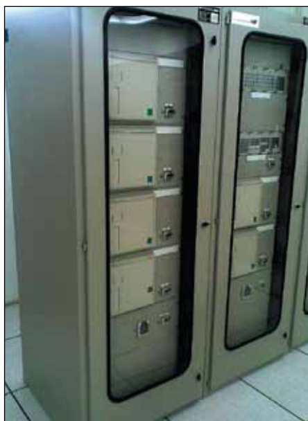
Рис. 5. Терминалы МУРЗ, установленные в стандартных шкафах со стеклянными дверями
